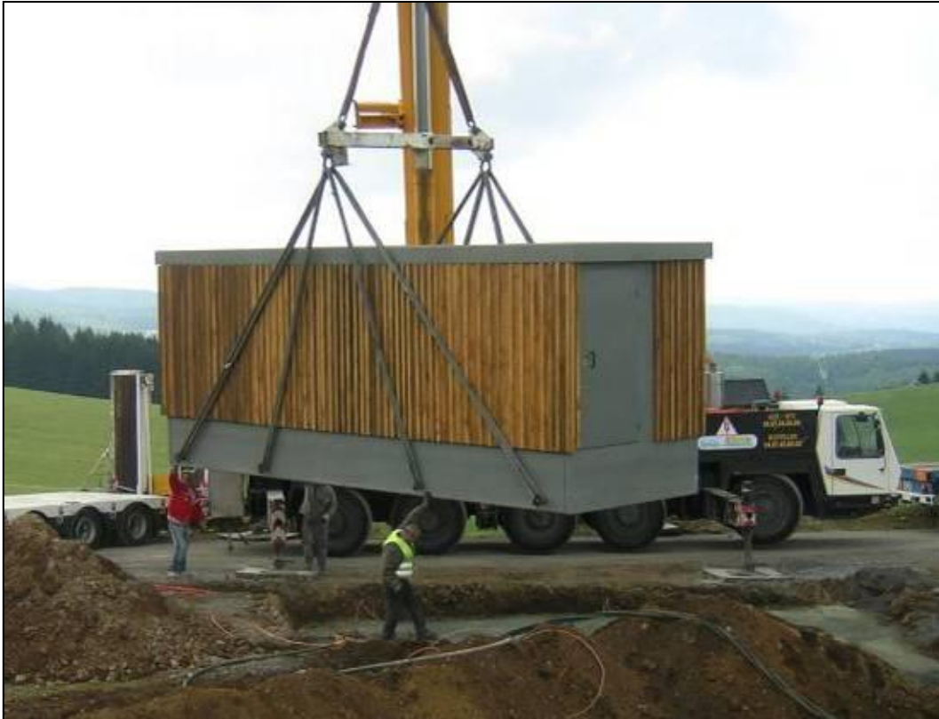
Exemple de livraison d'un poste de transformation électrique sur un parc éolien
