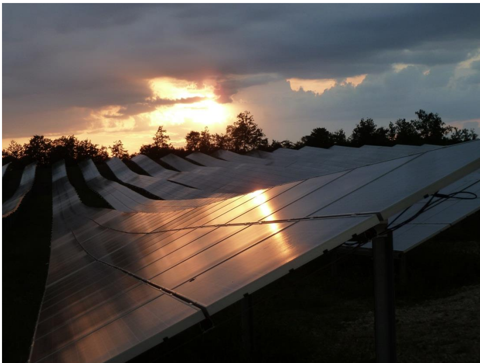
Centrale solaire du Sycala
